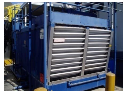
冷却塔 Cooling Tower
