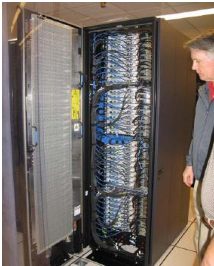
内部机架RD Hx, 90度开启 Inside rack RDHx, open 90°
